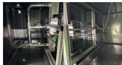
< 공조기 내 세정장치 설치 모습 >
