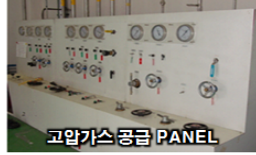
고압가스 공급 PANEL
